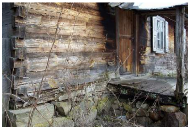
Fot.139. Bale na ścianach tego domu wyszły spod rąk traczy
