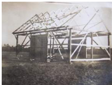
Fot.190. Budowa stodoły według nowych zasad. Szkielet zbudowany z bali obijano deskami i opołami
