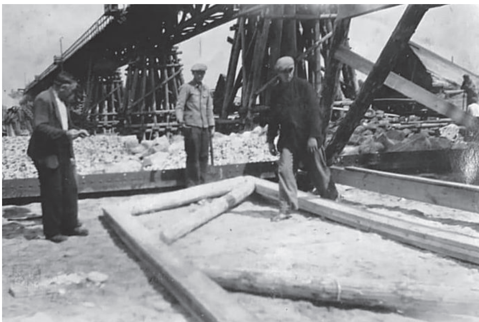
Odbudowa mostu we Fronoławie w 1946 r. Źródło: Zbiory Tomasza Modrasa za: (dostęp 10 maja 2022 r.)
